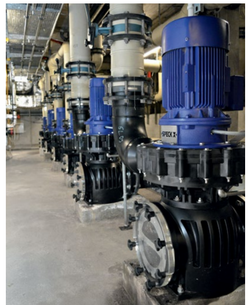
12 Vollkunststoff-Pumpen der BADU Multi Baureihe verrichten jetzt in den Technikräumen der Badeanlage ihren Dienst.
