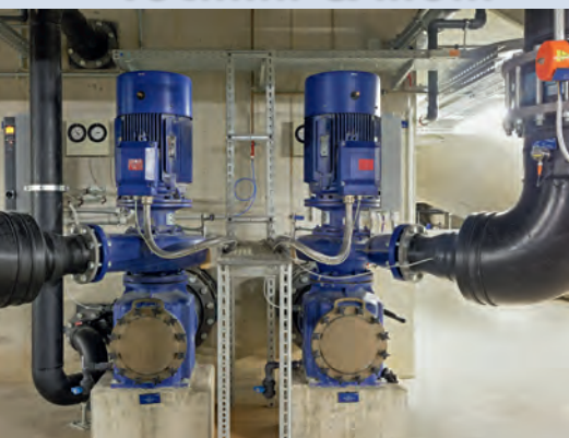
Speck-Pumpentechnik kommt überall im Familien- und Freizeitbad F3 zum Einsatz.
