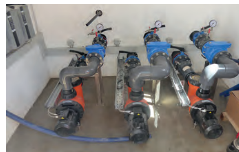
Die SPECK Pumpen sind im separaten Technikhaus eingebaut.
